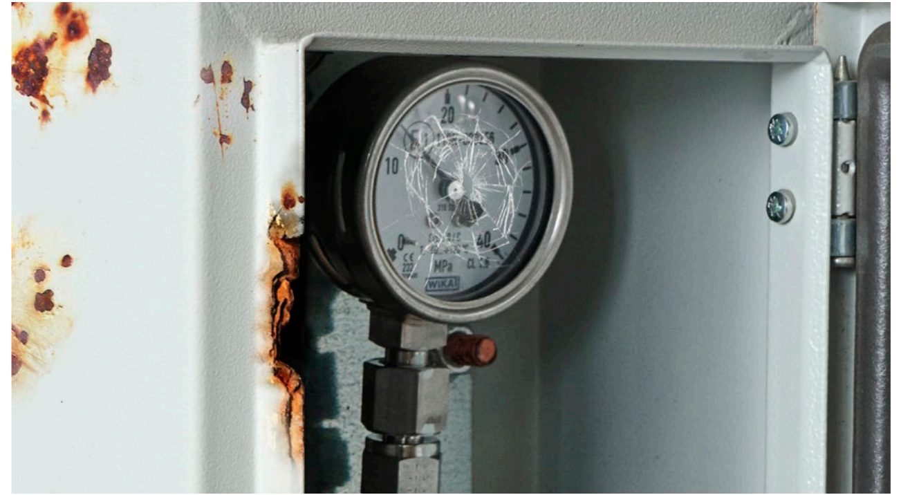
Kast voor vulaansluiting afwezig, vulaansluiting of manometer beschadigd → Kosten voor vervangen complete kast doorberekenen.
